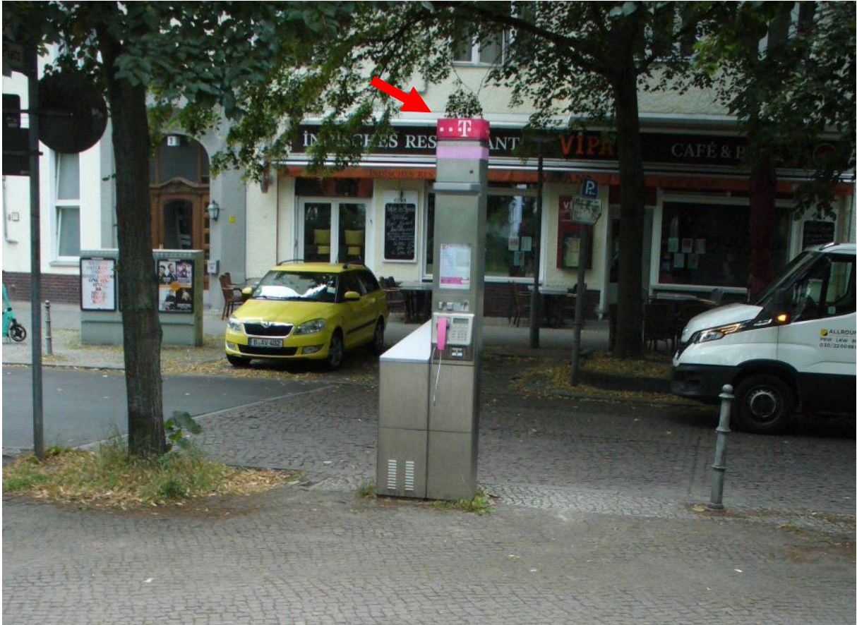
Bild 10.5.1: Standort 5: Antennen der Kleinzellenanlage (Telekom).
