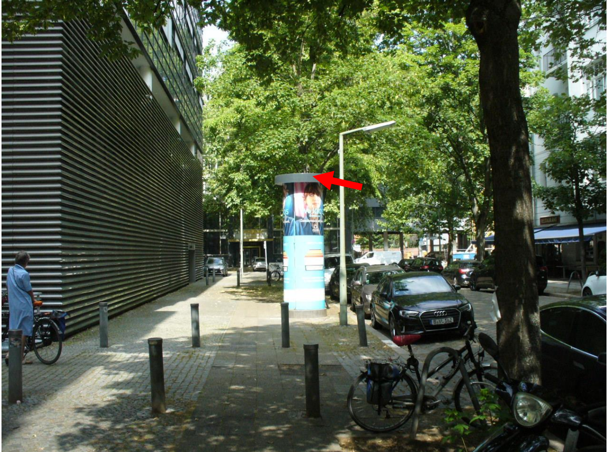
Bild 10.4.1: Standort 4: Antennen der Kleinzellenanlage (Telekom).
