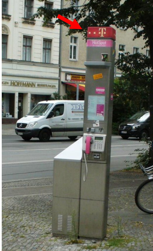
Bild 10.3.1: Standort 3: Antennen der Kleinzellenanlage (Telekom).
