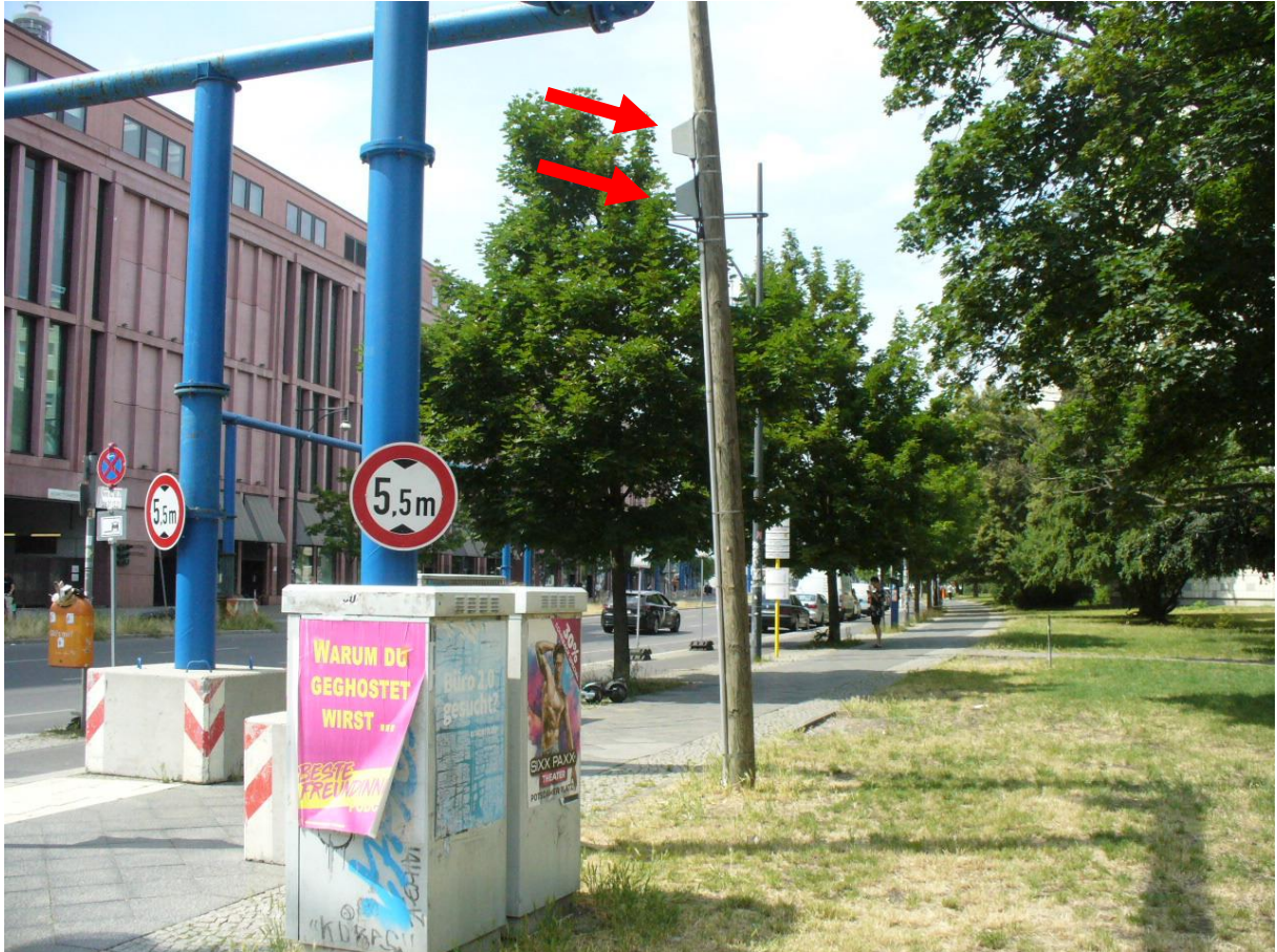
Bild 10.7.1: Standort 7: Antennen der Kleinzellenanlage (Vodafone).
