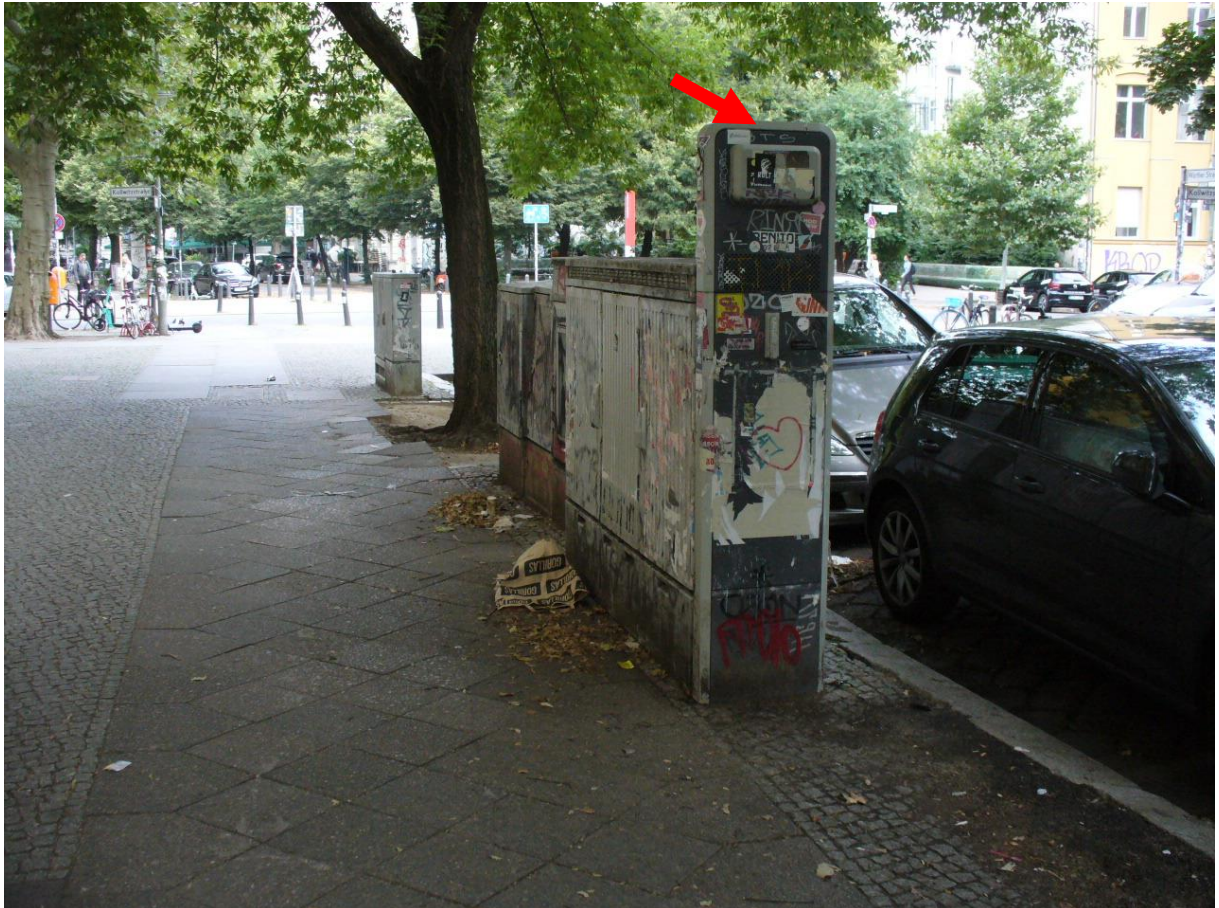
Bild 10.8.1: Standort 8: Antennen der Kleinzellenanlage (Telekom).
