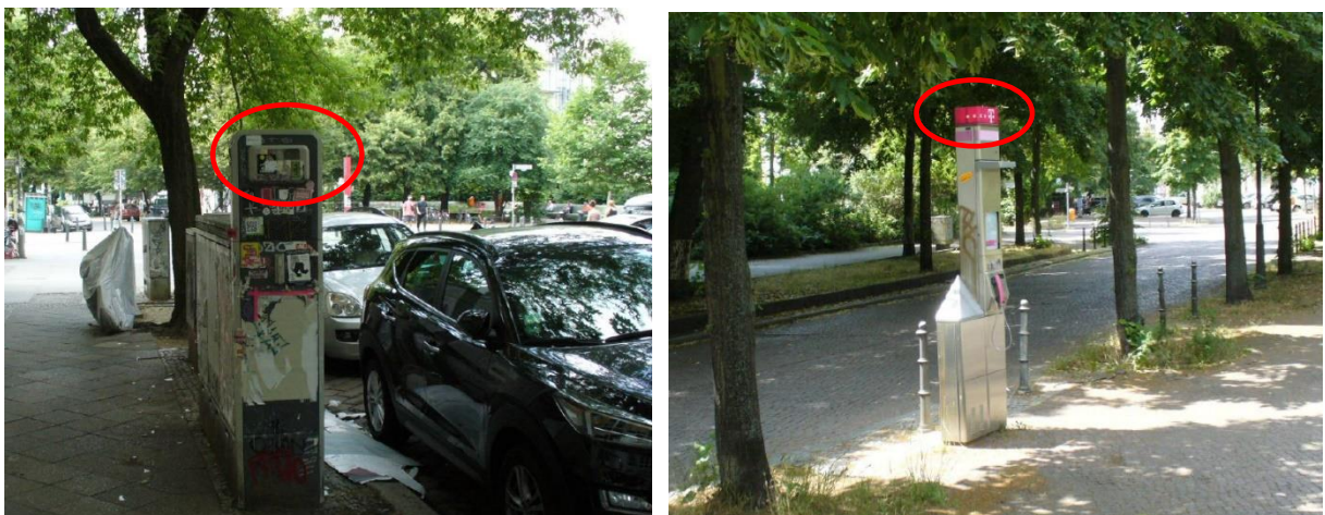
Bild 7.1: Kleinzellenbasisstationen, in deren Umgebung die Uplinkmessungen vorgenommen wurden. Links: Fernmelde-Multifunktionsgehäuse Wörther Straße (Kollwitzplatz). Rechts: Telefonsäule am Nikolsburger Platz.
