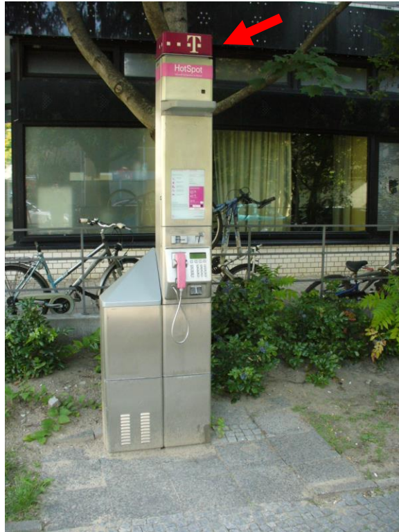
Bild 10.2.1: Standort 2: Antennen der Kleinzellenanlage (Telekom).
