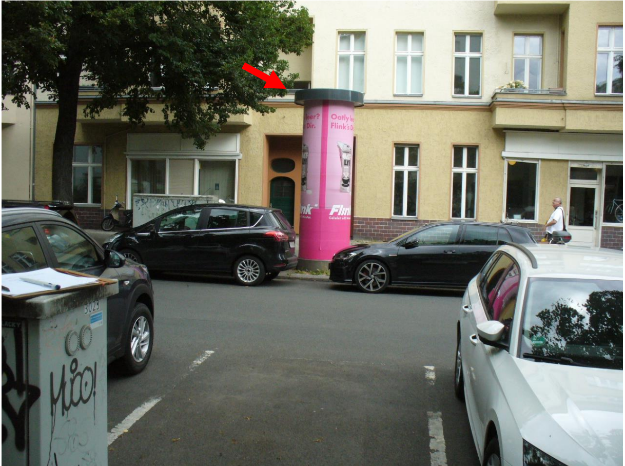
Bild 10.6.1: Standort 6: Antennen der Kleinzellenanlage (Telekom).
