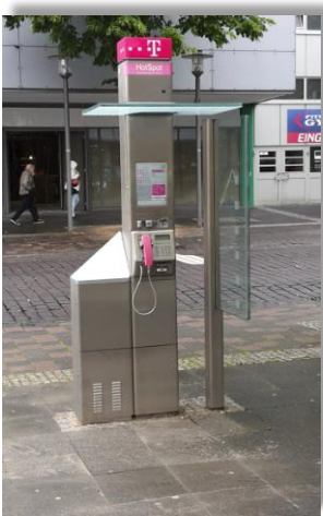
Telestation mit Small Cell < 10 W EIRP Sendeleistung
