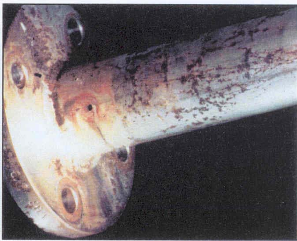
Bild 6.3-1: Rohr aus nichtrostendem Stahl mit Lochkorrosion /6-4/
